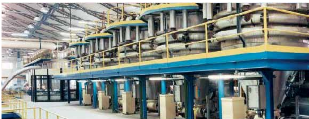
L'ex zuccherificio dell'Eridania a Jesi, riconvertito in impianto per la produzione di energia elettrica utilizzando semi di oleaginose come il girasole
